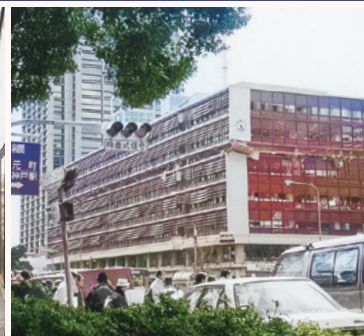
中間階の破壊
